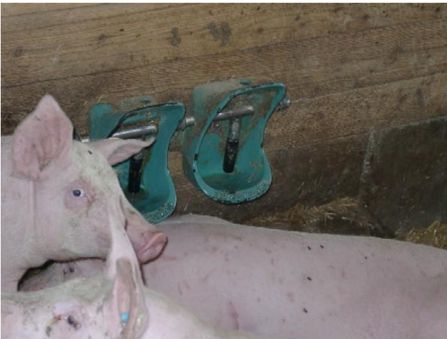
Abb. 3: Durchlauftränken an der Stall- außenwand mit im Stall verlegter Zirku- lationsleitung haben sich bewährt.
